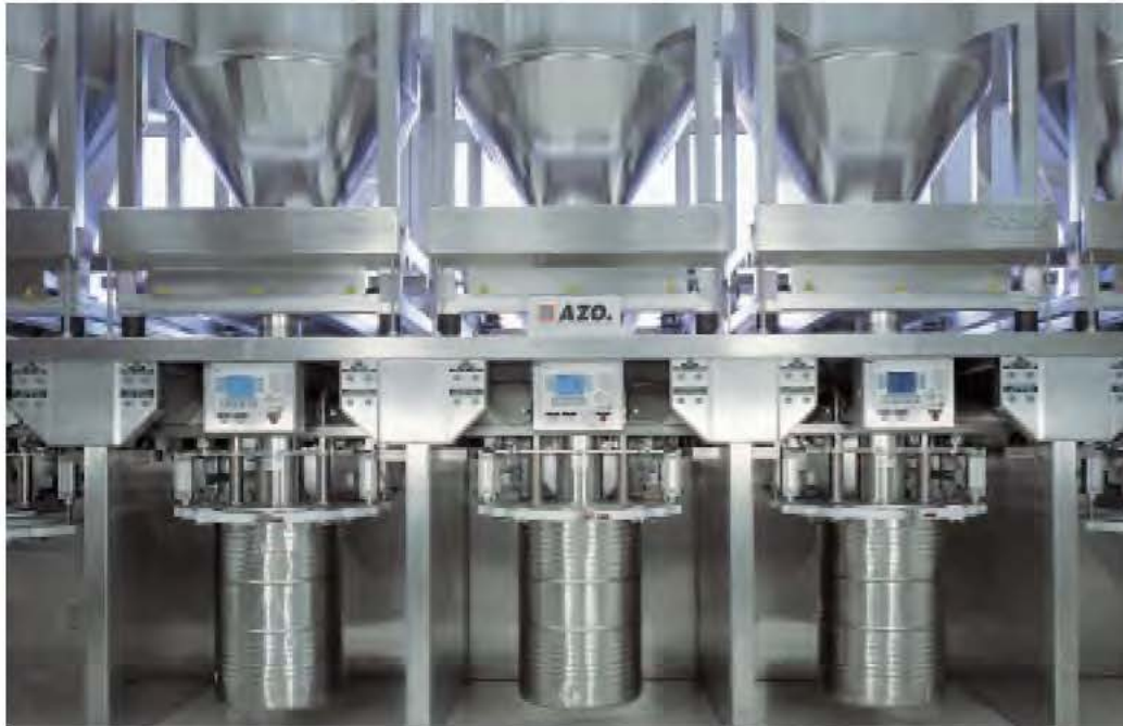
Zentrales Einwiegen von Wirk- und Trägerstoffen mit DOSITAINER® in Fasser.
